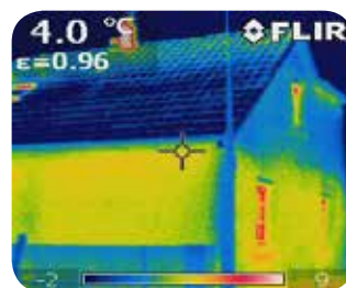
Erstein - Photographie thermique d'une maison © EIE Erstein
