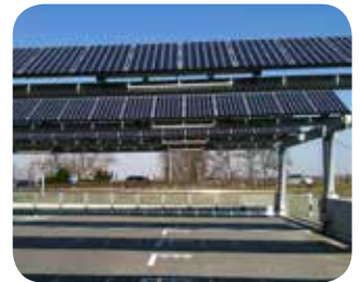
Erstein – Panneaux photovoltaïques sur le parking de la gare
